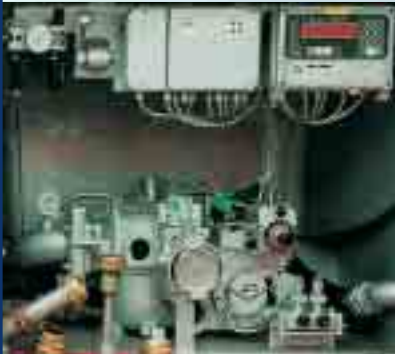
Armaturenschrank auf einem Straßentankwagen
